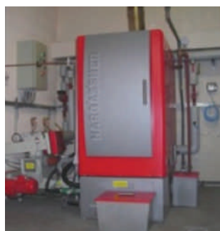
Chaufferie bois de la CC Malesherbois
