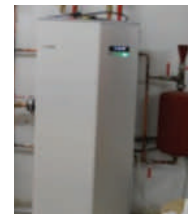
Pompe sur géothermie - BRGM
