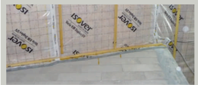
Défaut d'étanchéité : le collage de la membrane sur la partie maçonnée n'est pas assez soigné. Il aurait été nécessaire de mettre en œuvre un primaire d'adhésion permettant de préparer la surface à coller puis un large ruban adhésif adapté.
