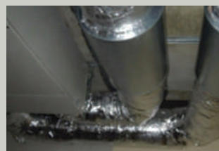
Exemple de pièce à son (rénovation de bureaux BRGM, à Orléans)
